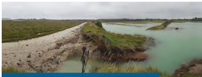
BRECHE ET POLDER INONDÉ EN SEPTEMBRE 2021
