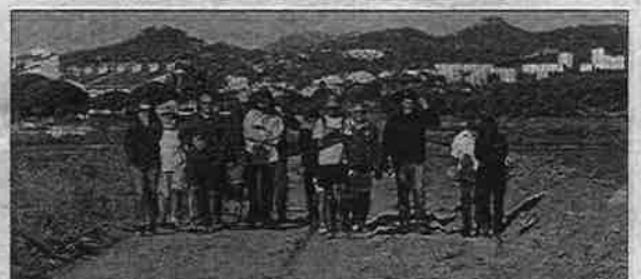
La digue (qui n'en était pas une au départ) derrière le canal d'alimentation a été surélevée dernièrement d'un mètre comme le laissent encore entrevoir les dépôts sur le côté droit. Cela afin de protéger les Vieux Salins du risque de submersion.
